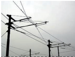
架空電纜(資料來源：取自網路)
